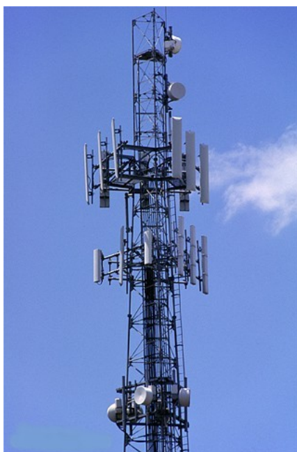
Figuur 2.3 GSM-mast met twee lagen GSM-antennes. Per laag staan de antennes in groepjes van drie in drie richtingen georiënteerd. De witte trommels dienen voor straalverbindingen met het mobiel schakel centrum.
